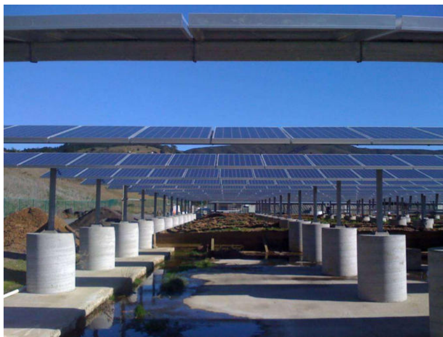
Figura 44: Esempio di impianto fotovoltaico con fondazioni ottenute mediante perforazione del terreno e successiva creazione del palo di fondazione con getto di cemento.
