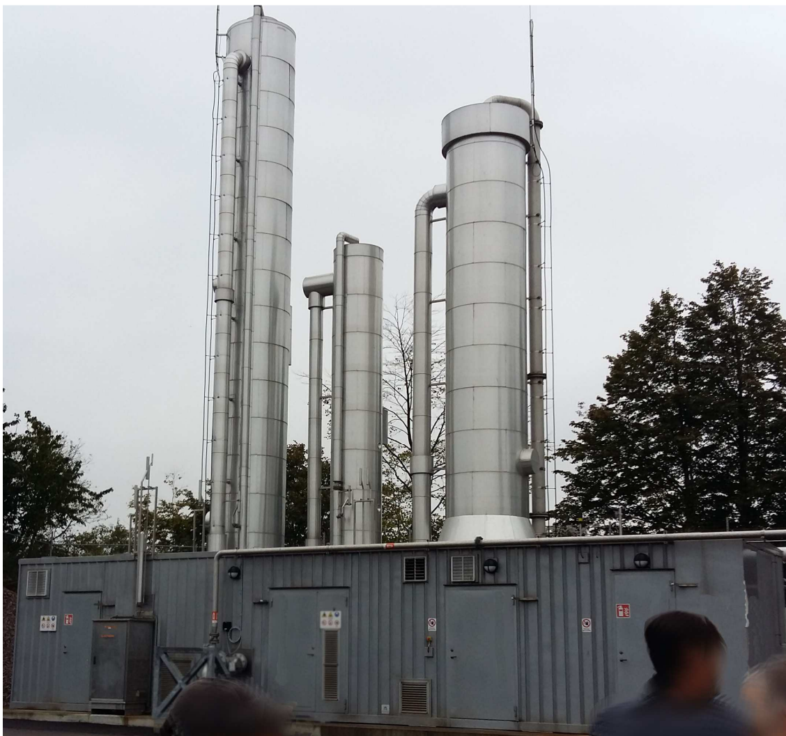
Esempio di impianto di upgrading con torri di assorbimento, flash e desorbimento e container per le apparecchiature
