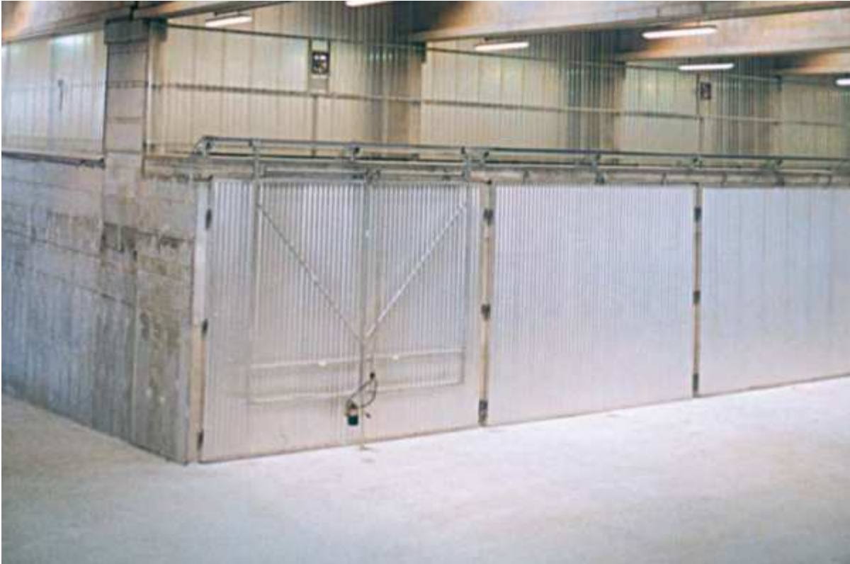
Esempio di biocella aerobica con portoni a tenuta.
