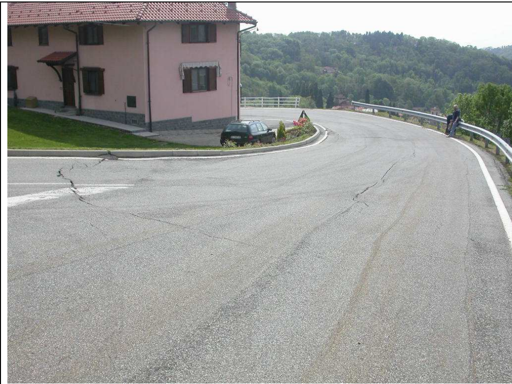
Foto 2 Immagine area oggetto di cedimento intervento 1.
