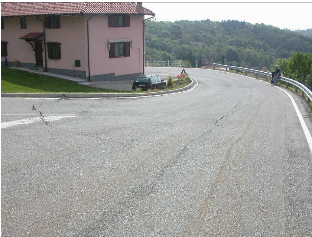
Foto 2 Immagine area oggetto di cedimento intervento 1.
